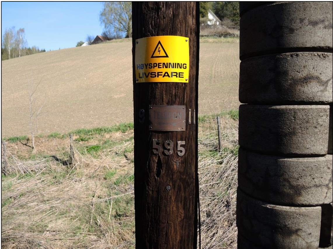
Figur 7: Mast for kontaktledningsanlegg med skilt. Foto: SHT
