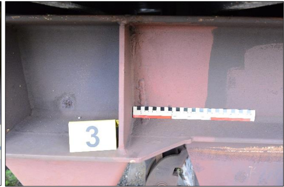
Figur 13: Sveiset sprekk ved høyre fremhjul. Foto: SHT
