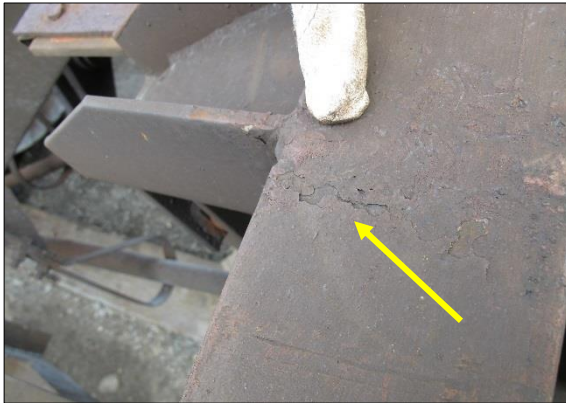
Figur 15: Begynnende sprekkdannelse på toppen av langbjelke, høyre fremside. Foto: SHT
