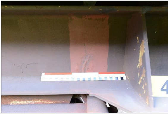
Figur 12: Sveiset sprekk ved høyre bakhjul. Foto: SHT
