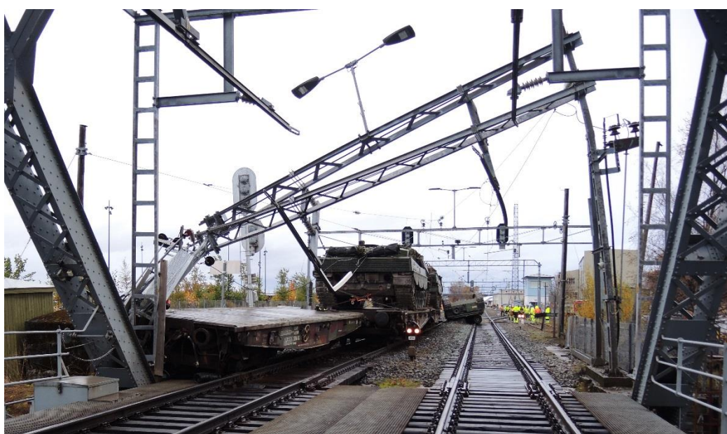
Figur 4: Skansen bru dagen etter avsporingen. Foto: SHT
