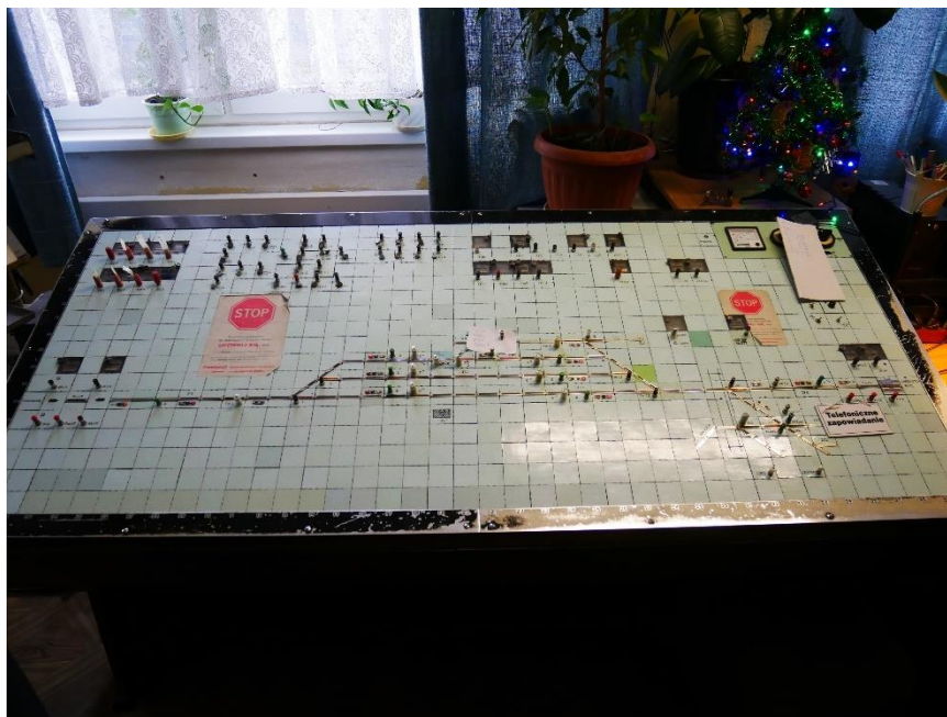
Fot.28. Pulpit nastawczy umieszczony w centralnym miejscu pomieszczenia nastawni stacji Ozimek
