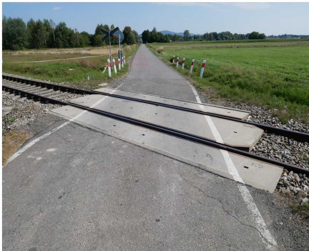
Zdjęcie 4. Widok na pomost przejazdu i drogę, z której nadjechał samochód - materiał Zespołu badawczego
