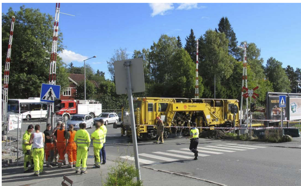
Figur 1: Bilde fra Slemdal planovergang av pakkmaskinen (kilde: SHT).
