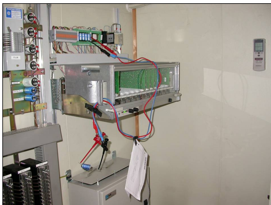
Figur 9: Grensesnitt system EF 180 på Slependen blokkpost. Dette overfører signalinformasjonen mellom reléanlegget på blokkposten og datastillverket på Sandvika stasjon via en telekommunikasjonskabel.
