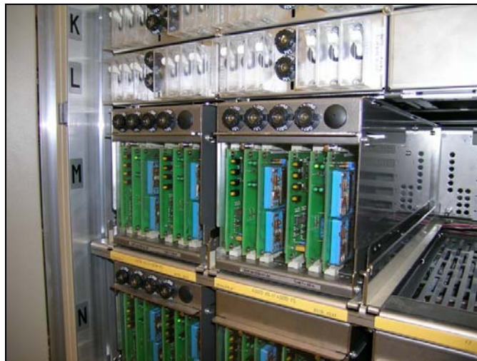
Figur 10: Bilde av objektcontroller til signal N 4323
