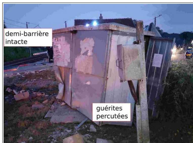
Figure 19 : état des lieux : les dégâts sur les installations du passage à niveau photo Gendarmerie Nationale, légende BEA-TT
