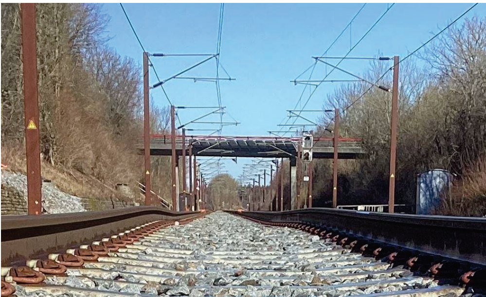
Foto 1. Right track, Roskilde - Viby Sj. Seen in direction towards Roskilde. Foto: Banedanmark.
