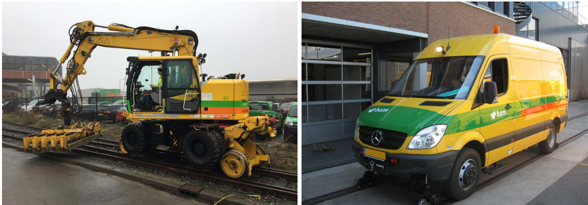
▲ Figuur 4: Voorbeeld van een kraan op lorries met hulpmiddel voor het vervangen van dwarsliggers en een lasbus, beide voertuigen zijn railwegvoertuigen (foto's: BAM).
