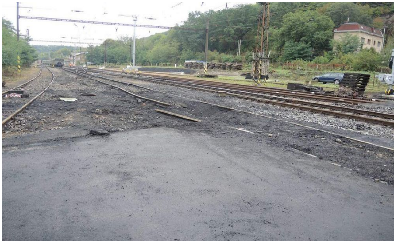
Obr. č. 8: Pohled na poškozenou infrastrukturu
