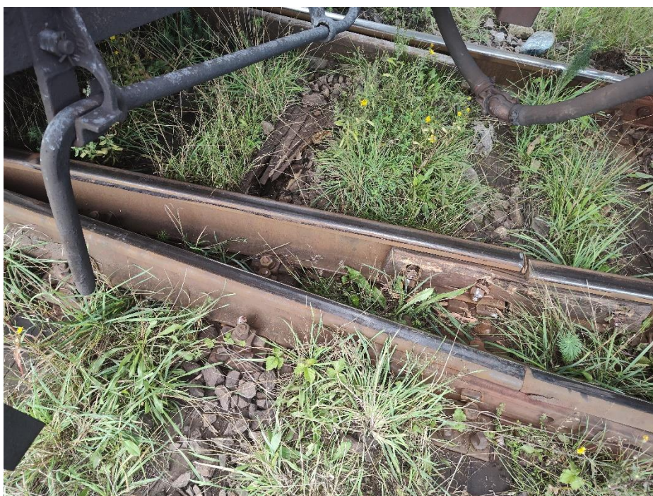
Figura nr.7 – starea traverselor aflate în compunerea schimbătorului de cale R8.
