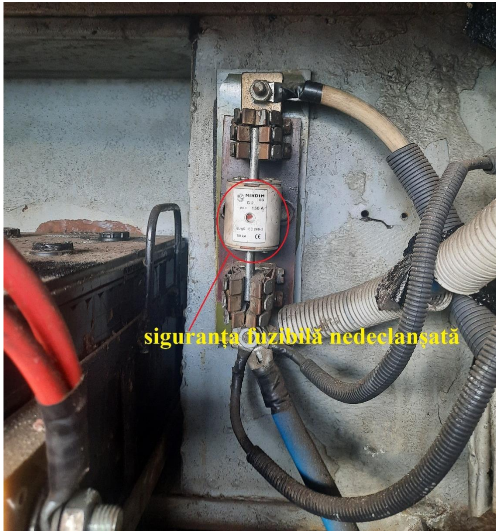
Figura nr.1 – siguranța fuzibilă a bateriei de acumulatori
