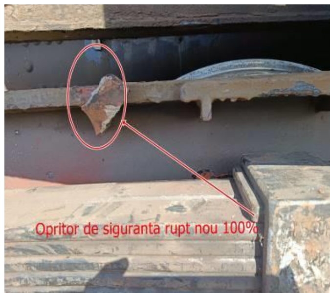
Foto nr.3 – opritor de siguranță ruptură 100% nou
