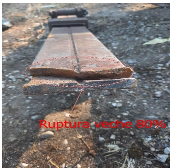
Foto nr.7 Ruptură veche 80%
