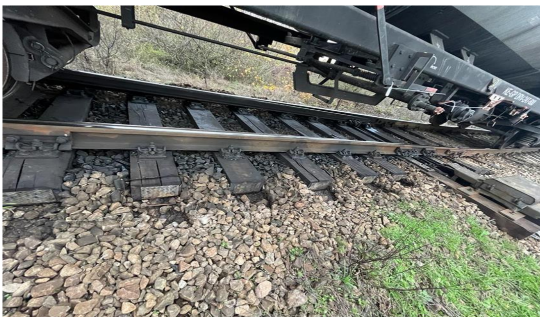
Foto nr.9 – Deriparea pe zona macazului
