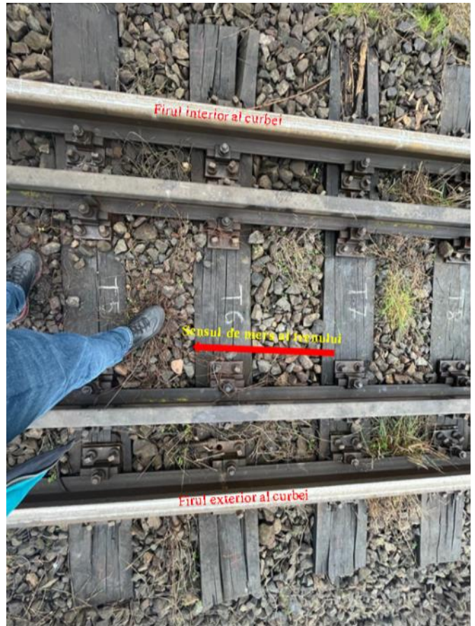
Foto nr.12 - Starea tehnică a traverselor T_5 , T_6 și T_7
