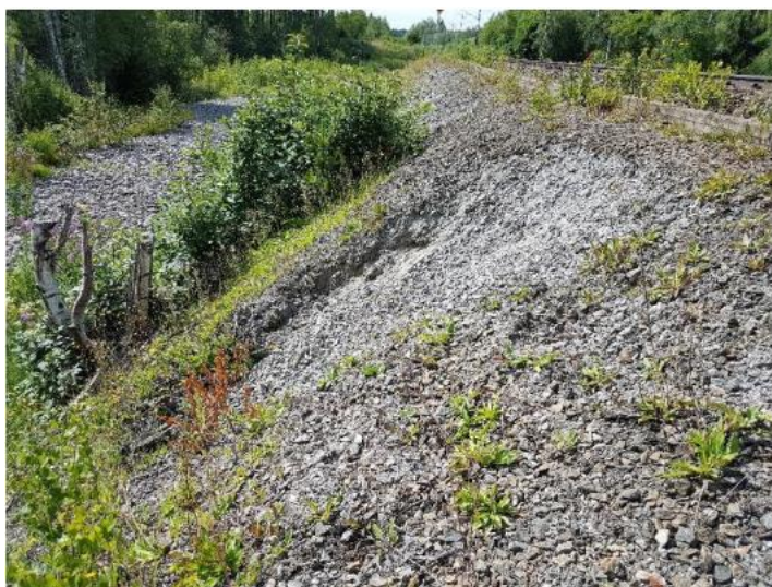
Figur 11. Bilden visar en typskada från handboken. Bilden är från Iggesund där en del av bankslänten tryckts ut pga. vattentryck. Foto: Trafikverket.
