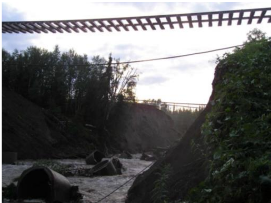
Figur 22. Bild från Banverkets utredning av urspårningen i Are. I förgrunden räl i luften över en bortspolad banvall. I bakgrunden vägräcken i luften över en bortspolad vägbank. Källa: Banverket
