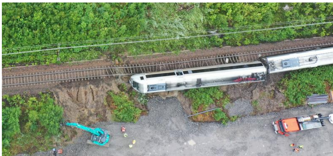
Figur 3. Banvallen med rasområdet och det urspårade tåget. Drönbild tagen några dagar efter olyckan. Foto: Trafikverket.
