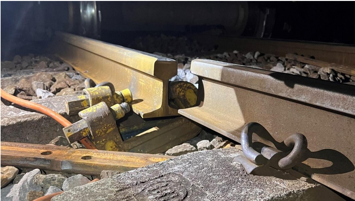
Figur 6: Avsporingssstedet med forskjøvet skinnereskjøt. Foto: Bane NOR SF
