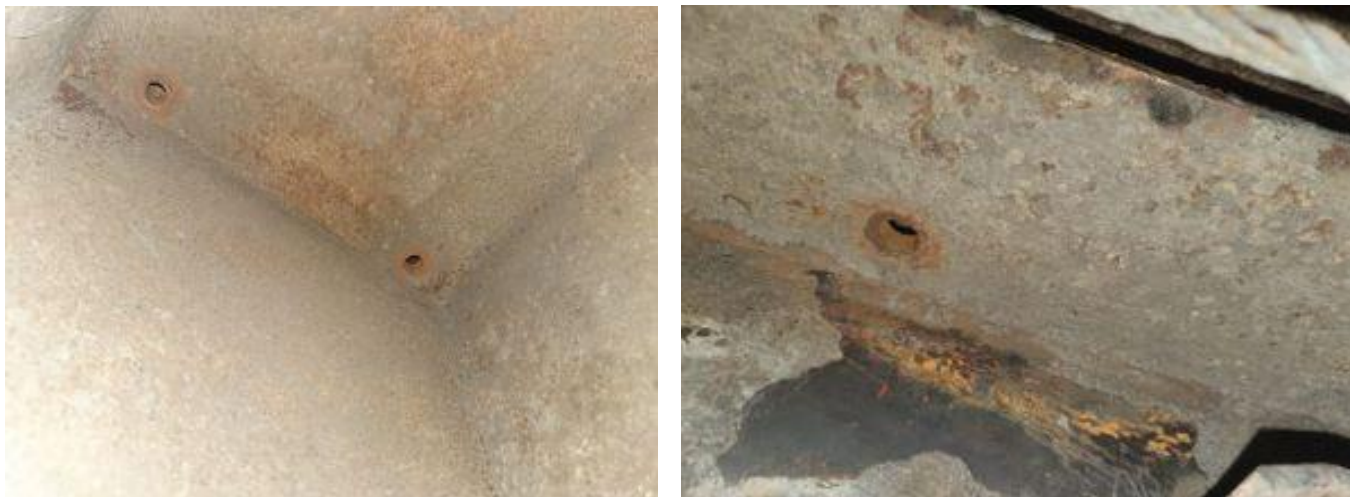
Foto nr.7: Găurile de prindere a pietrei de frezare pe cadrul boghiului
