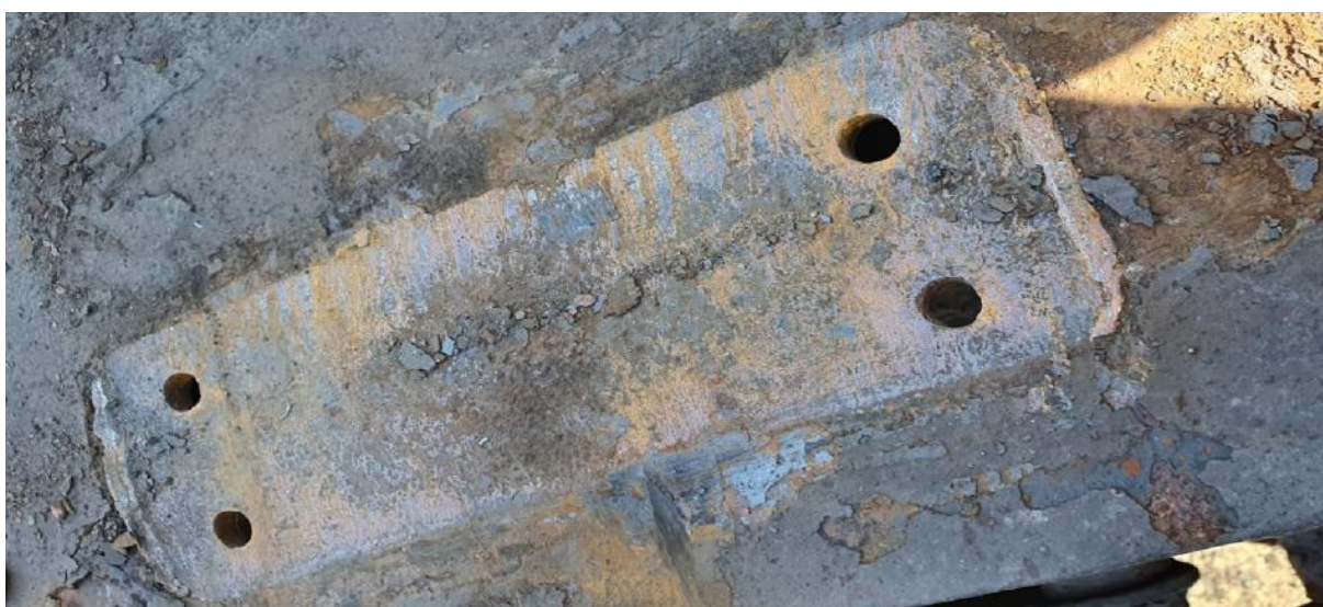
Foto nr.9: Urme proaspete de rugină pe cordoanele de sudură și pe cadrul boghiului pe suprafața de așezare a pietrei de frezare (9 zile de la producerea evenimentului până la efectuarea constatărilor)
