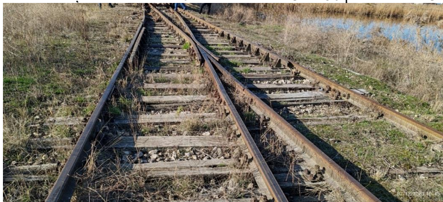
Foto nr. 1 – locul producerii accidentului
